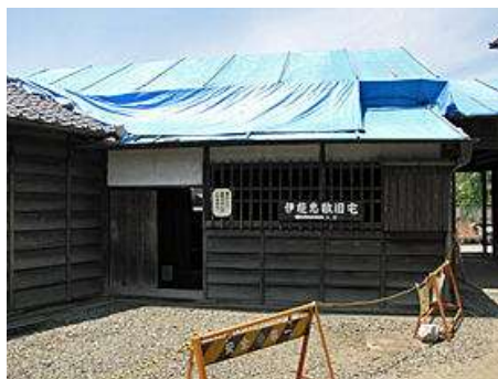
東日本大震災の翌年ゆえ、屋根にブルーシート
